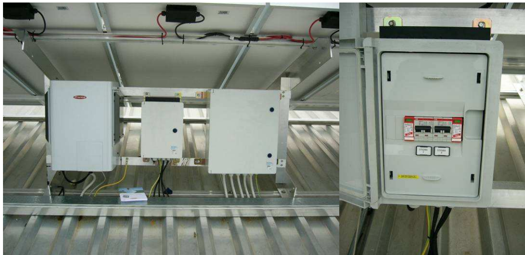
Insieme di quadro di stringa e inverter (NOSTRE MM)
